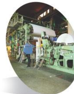
Технологическое оборудование: точность и регулировка
